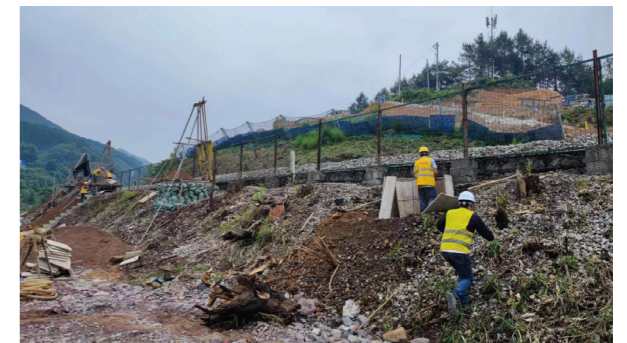
公路边坡监测系统
