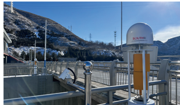
危险路段安全监测系统
